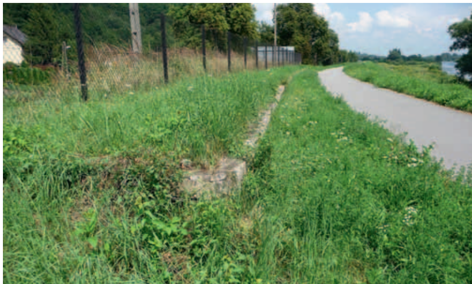
Na przystanku bielańskim pozostała betonowa płyta peronu, niemal dokładnie porośnięta trawą.
