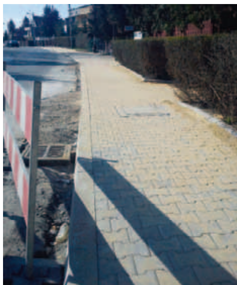
Ul. Królowej Jadwigi, remont chodnika – kolejna inwestycja pilotowana przez Radę Dzielnicy VII/ fot. Ł. Filipiak
